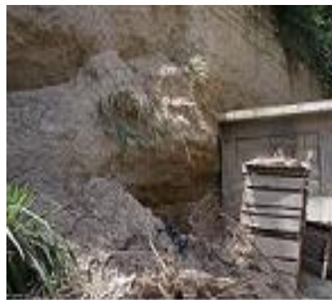
Figura 54. Vivienda ubicada en el pie del talud con pared casi vertical entre calle 10 y calle 14. Consejo Popular Altamira. Santiago de Cuba. Foto tomada por la autora.
