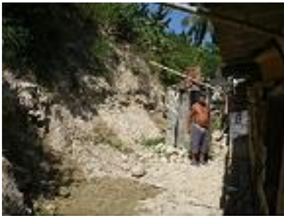
Figura 55. Desprendimiento del material del talud, por excavaciones o banqueos para la ampliación de las viviendas. Foto tomada por la autora
