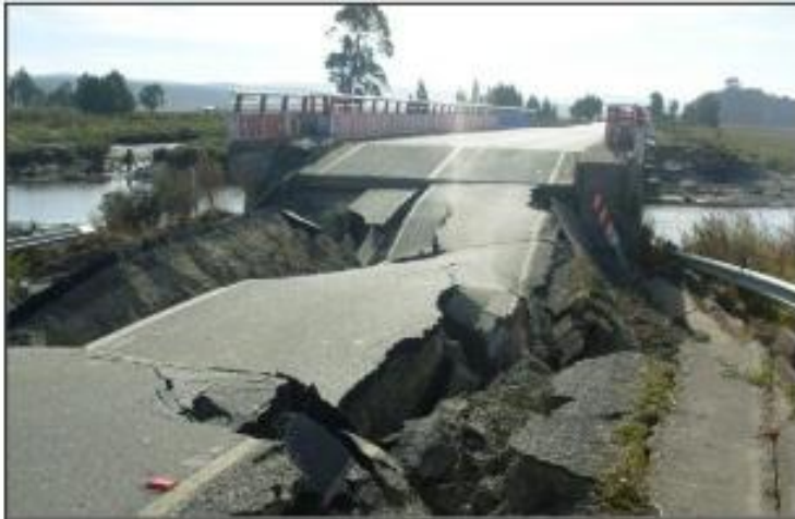
Figura 4. Colapso de puentes y daños por grietas en Chile. Fuente: Falcón y Ramírez, 2012.
