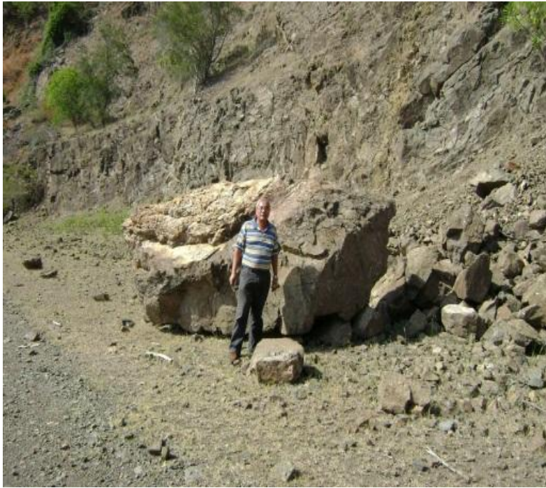
Figura 32. Caidas y desprendimientos de rocas en un talud con peligro para el vial del sector Guamà. Foto tomada por la autora.
